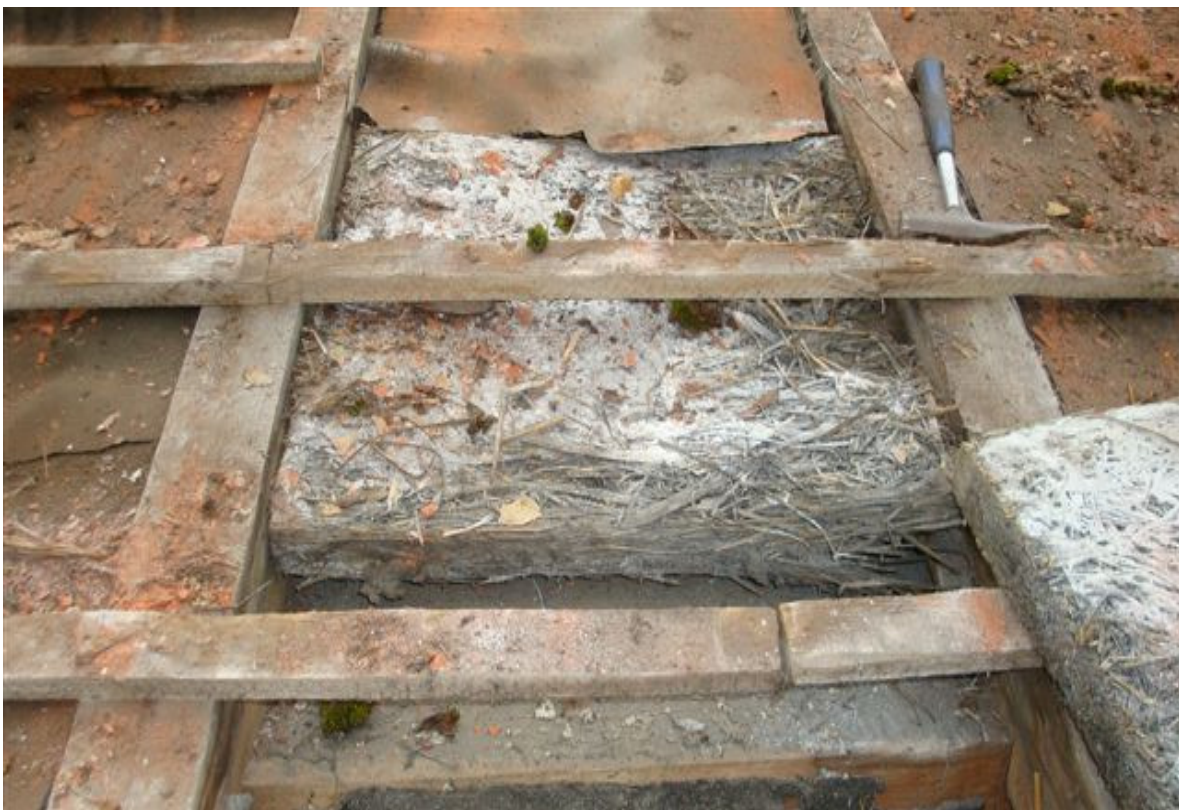
Schimmel in den Heraklitplatten im Dach
