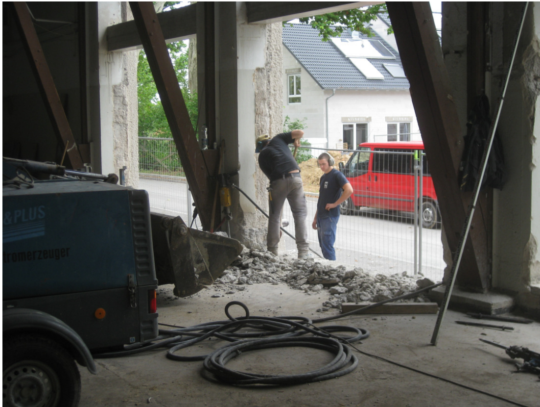
Ausbruch Betonsockel im Fensterbereich
