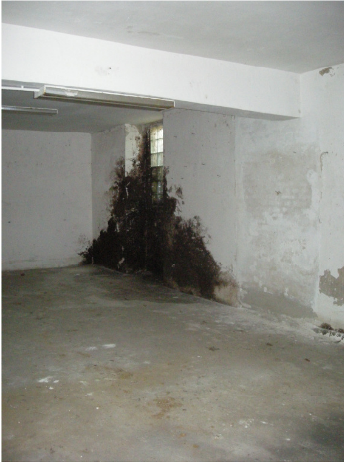
Schimmel im Untergeschoss
