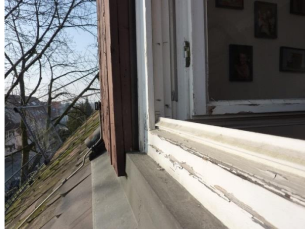
Zustand Fenster DG- Bestand
