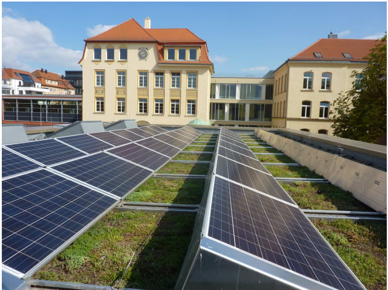
Photovoltaikanlage auf extensiv begrüntem Dach
