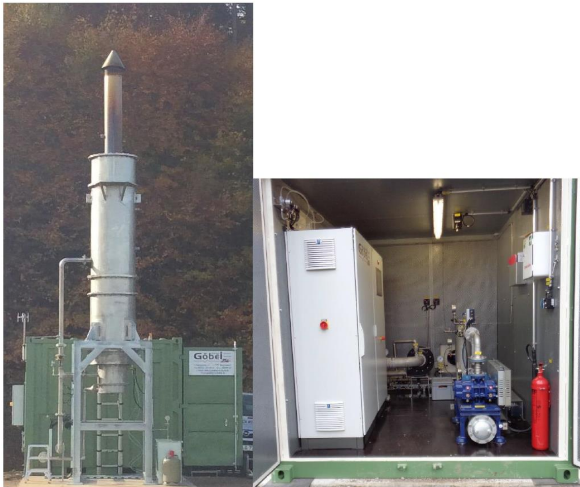
Schwachgasbehandlungsanlage inkl. Innenansicht des Containers, Fa. Göbels
