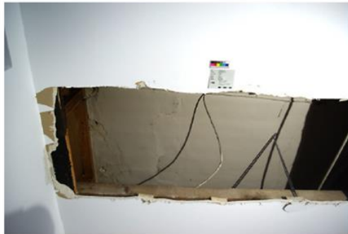
Foto 20: Sondage in der GK-Decke; Sondage 10.
