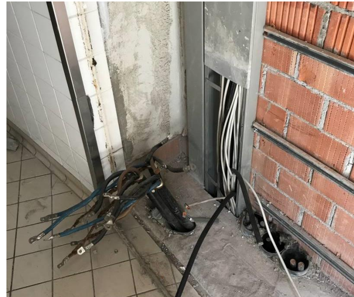
Mangelhafte Schottungen in den Steigschächten
