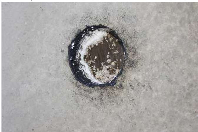
Bild 6: Feuchtigkeit unterhalb der Polystyrolämmung
