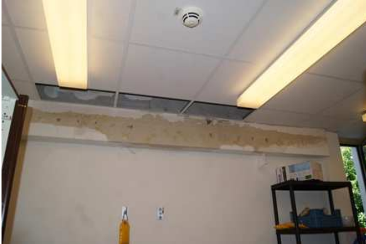
Bild 1: Sportgeräteraum, Wasseraustrittsstelle Außenwand
