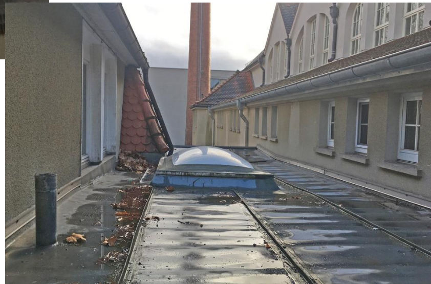
Dachgeschoss undichtes Blechdach
