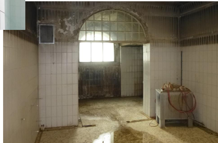
Erdgeschoss Sauna → Gruppe 1, Schimmelbefall
