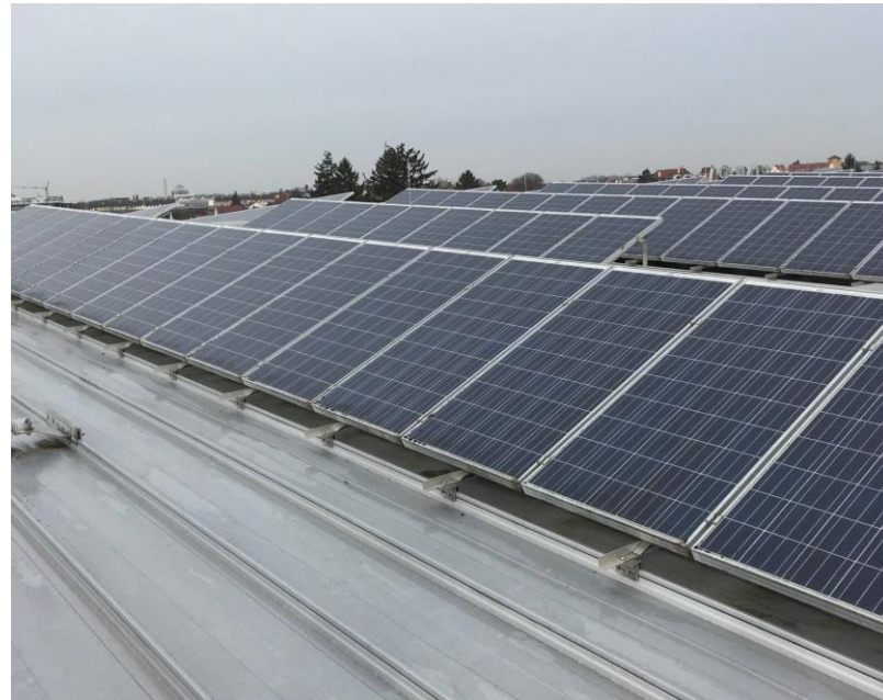
Leistung der bestehenden Solaranlage: max. 127 kWp Repowering ca. 170 kWp
