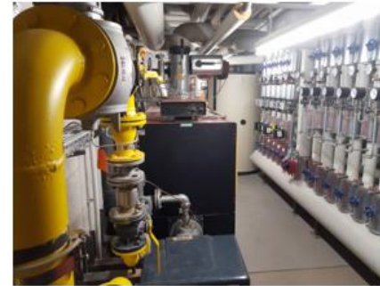
Abbildung: Alte Gaskesselanlage Schulkomplex Eglosheim. Durch die geplante Fernwärmeanbindung können jährlich über 200 Tonnen CO 2 eingespart werden.
