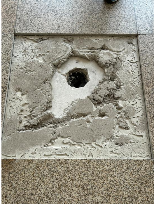
Lose Platten Foyer, Mangelhafter Unterbau
