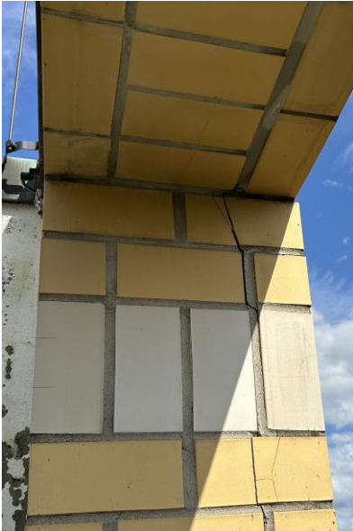
Risse und Schäden Klinker-MW
